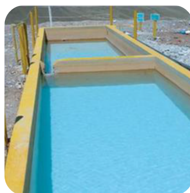
TRATAMIENTO DE AGUAS
