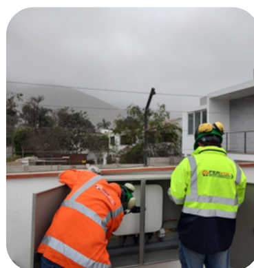
SISTEMA ON GRID PARA VIVIENDA
