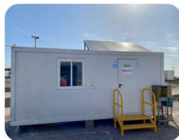
SISTEMA OFF GRID PARA OFICINA
